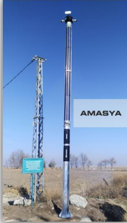
OYAK A.Ş. Köy CCTV Sistemi
